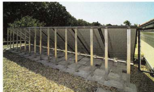
Exakt auf Wind- und Schneelast abgestimmte Aufständungen am Flachdach
