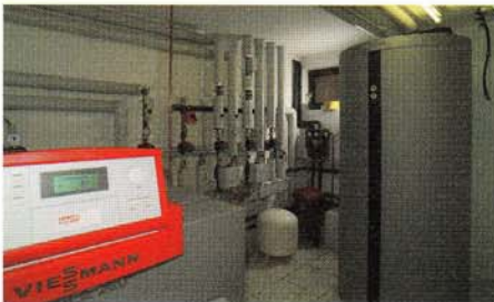
Der Technikraum mit dem Tieftemperatur-Ölkessel Vitola 200 und dem Testsieger der Stiftung Warentest 03/2009: Das Solarpaket bestehend aus dem multivalenten Kombispeicher Vitocell 340-M, der elektronischen Regelung Vitosolic 200 und den am Dach montierten Sonnenkollektoren Vitosol 200-F
